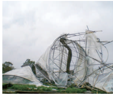
■ 台風8号による被害2
